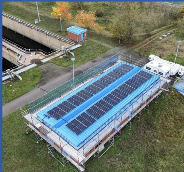
Neue PV-Anlage auf der Kläranlage Straupitz
